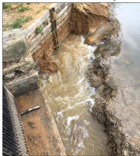
Foto poškozeného přepadu mluví za vše.
